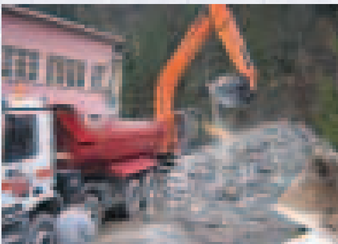
La seconde pelle mécanique, une Hitachi de 21 tonnes, charge les déblais sur les bennes des camions.
